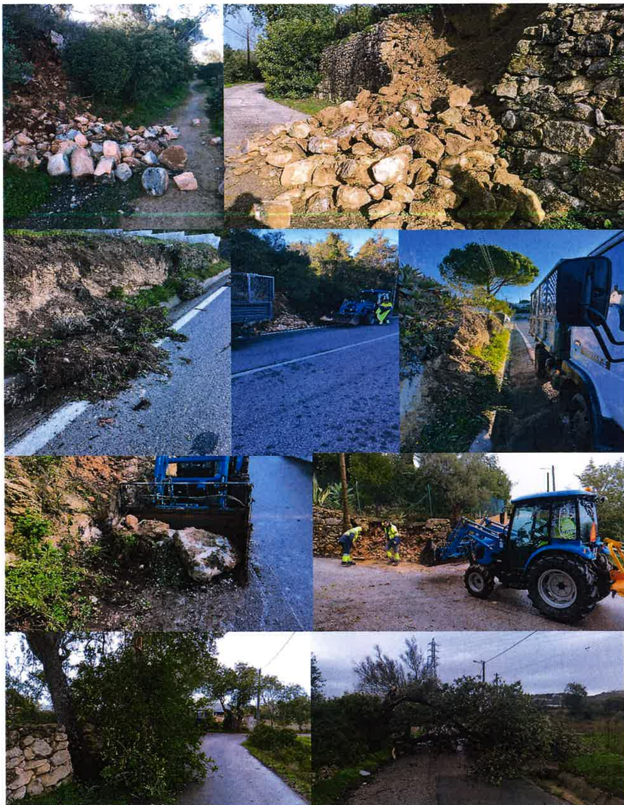
Imagem 8 – Intervenções diversas devido ao mau tempo – 1º Trimestre 2026
